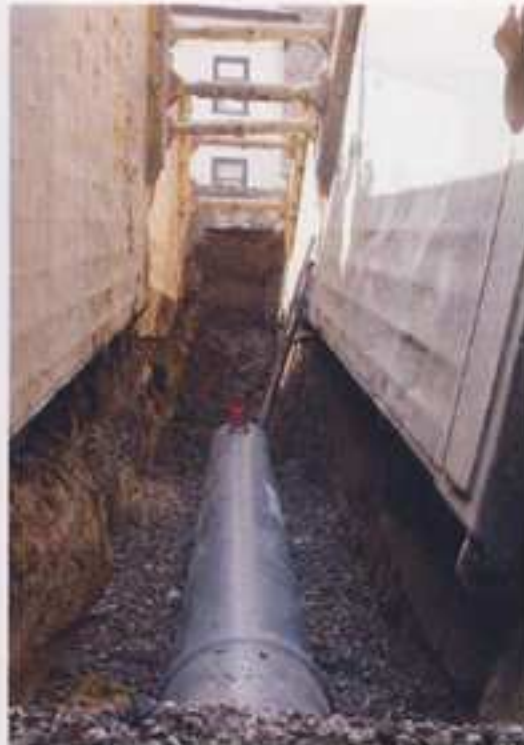
Wegen des geringen Eigengewichtes, der hohen Dichtigkeit und Steifigkeit entschied sich die Stadt Grebenstein für den Einsatz von Connex-Rohren.
