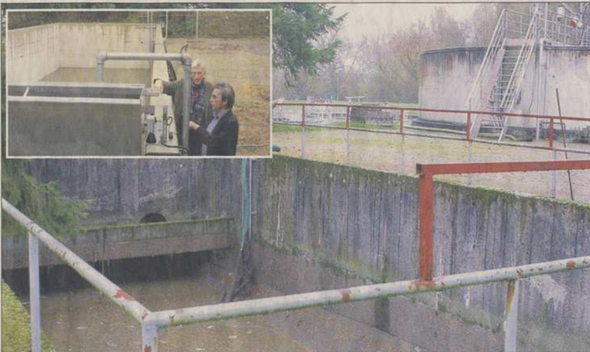
Noch ist es in Betrieb: Das alte Regendurchlaufbecken ist fünf Jahrzehnte alt und undicht. Im Frühjahr wird es zugeschüttet. Als Stauraum steht künftig das neue, doppelt so große Becken zur Verfügung (kleines Bild).
