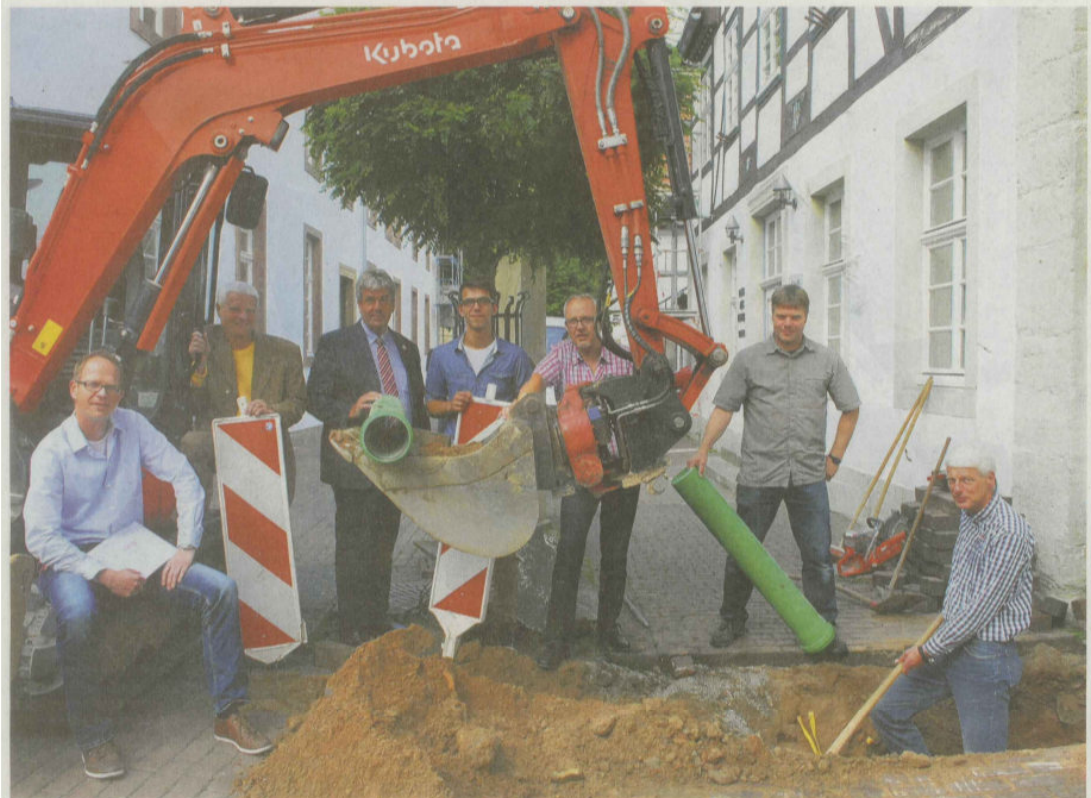
Startklar: Ab dem 5. Oktober soll mit der Neugestaltung des Marktplatzes begonnen werden. Im Vorfeld ist jedoch noch die Kanalisation an einigen Stellen zu sanieren. Alexander Frewer, stellvertretender Betriebsleiter Wasser- und Abwasserwerk, Dr. Werner Schwarz, Vorsitzender des Bauausschusses, Bürgermeister Hermann Temme, Tobias Bielefeld, Ingenieurbüro Turk, Johannes Groppe, Fachbereichsleiter Planen und Bauen, Christof Münstermann, Technischer Betriebsleiter und Firmenchef Johannes Schönhoff (v. l.) haben schon mal den Spatenstich.
