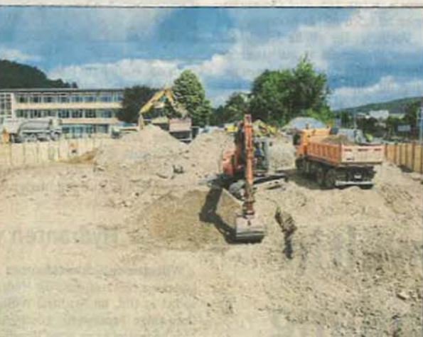
Seit Mitte Juni laufen die Bauarbeiten für die 4,50 Meter tiefe Baugrube des neuen Hallenbades an der Lütmarser Straße in Höxter.
