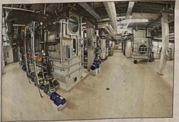
Vollgestopft mit modernster Regeltechnik: Die Unterwasserwelt des Hallenbades ist spannend und eine Herausforderung zugleich.
